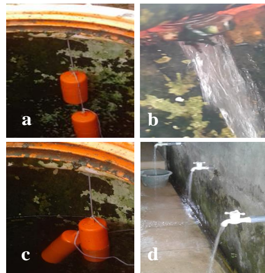
Gambar 12. Kondisi air pada tanki
